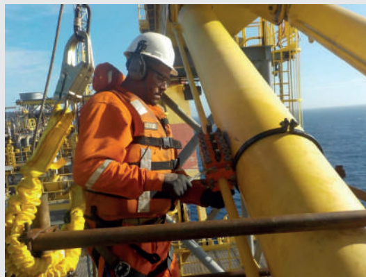
Reparo de vazamento de óleo em linha de guindaste 1.1/4" (Pressão: 370 barg / Temperatura: 70 °C)
