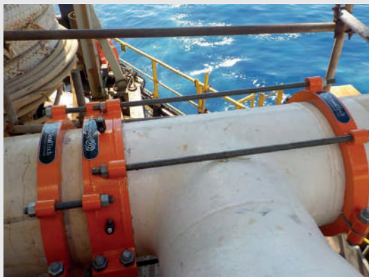
Reparo de vazamento de óleo cru em linha 20" (Pressão: 15,5 barg / Temperatura: 37 °C)
